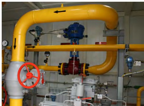
Блок переключения АГРС «Саратов-10М». Автоматическая байпасная линия
