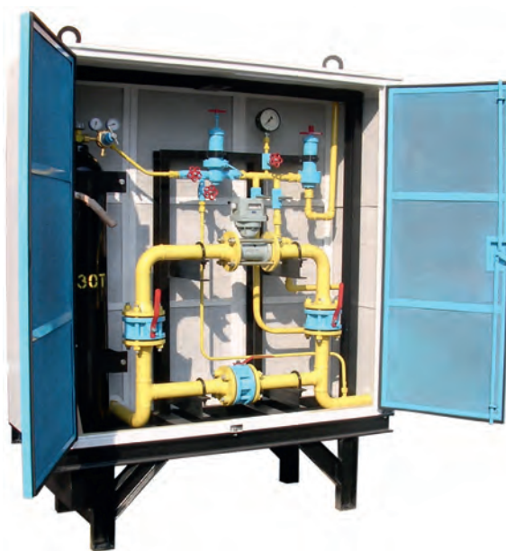
Блок перекачки и замера расхода газа
