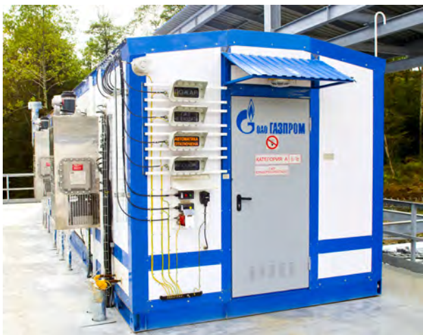
АГРС Адлерского района города Сочи. Блок-бокс аналитический
