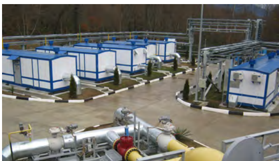
АГРС Адлерского района города Сочи. Блок-боксы редуцирования. Узел переключающих кранов подогревателей газа
