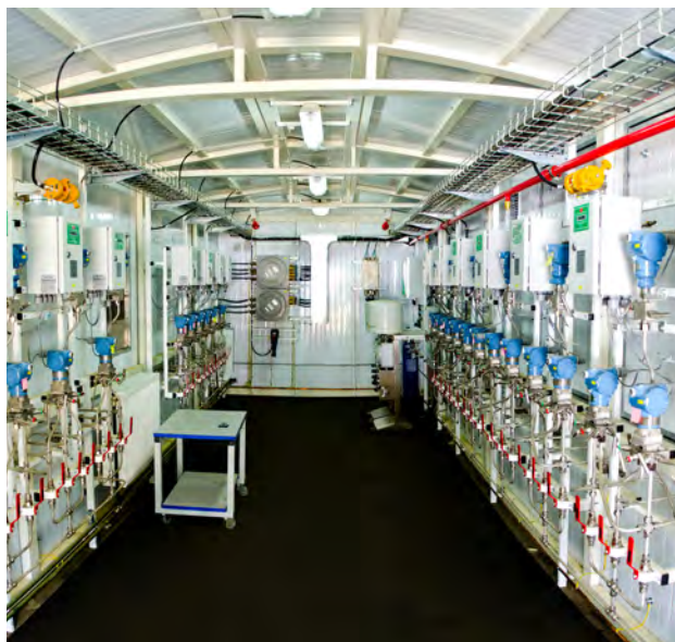
В блок-боксе расположено оборудование для определения качественных показателей газа и вычислители замера расхода газа
