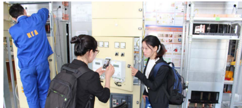
Представители компании Ningbo Shengjiu Cabinets Lock Co.,Ltd на участке сборки низковольтных распределительных щитов
